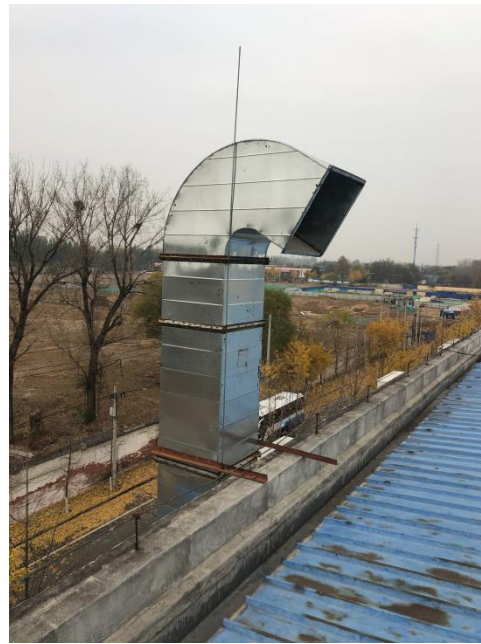
制剂二车间排气筒
