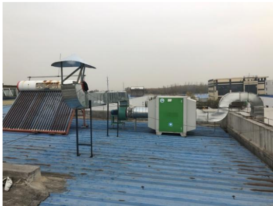
二车间热交换废气净化装置
