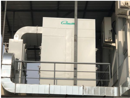
制剂二车间净化设备
