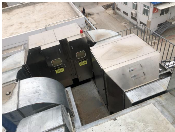
制剂一车间净化设备
