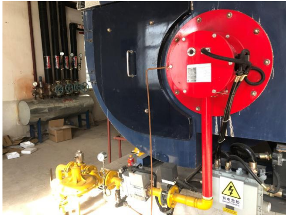
锅炉低氮燃烧器
