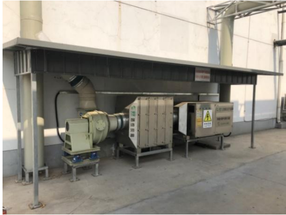
污水处理站废气净化装置
